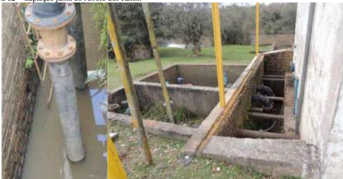
Figura 12 – Captação junto ao Arroio dos Ratos.
