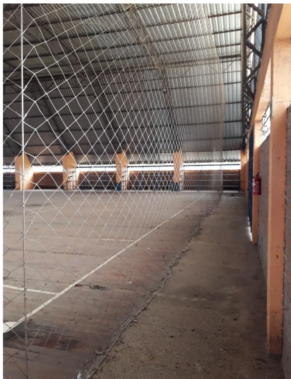
Figure 10: Quadra e piso lateral
