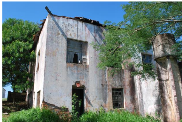
Vista dos fundos, em que a degradação está mais avançada.
